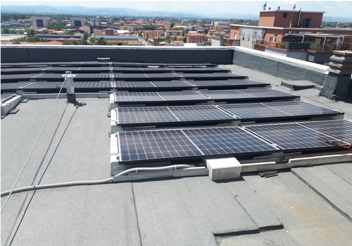
CONDOMINIO DI MODENA (IMPIANTO FOTOVOLTAICO)
