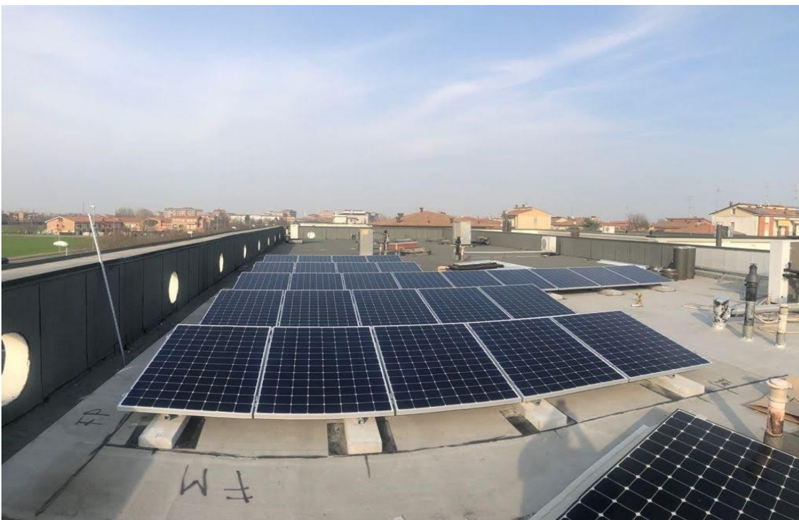
FOTOVOLTAICO SEDE AMATI SPA
